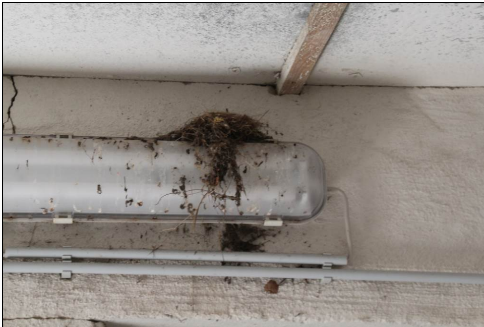
Abbildung 18: Nest einer Amsel, das vom Hausrotschwanz nachgenutzt wurde
